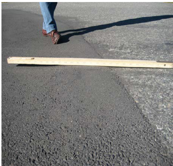
Figur: Nivåsprang mellom, nytt og gammelt dekke
