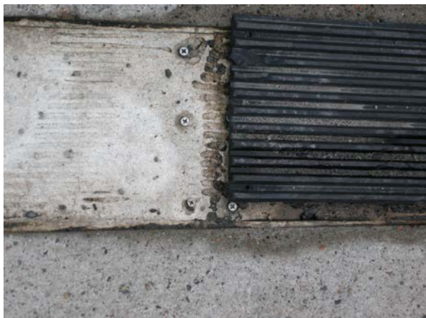
Figur: Skadd ledelinje i betongdekke
