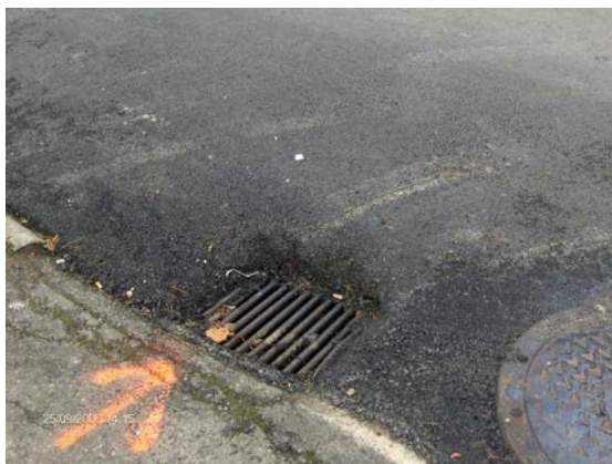
Figur: Manglende heving av sluktopp ved asfaltering kan gi nivåsprang.
