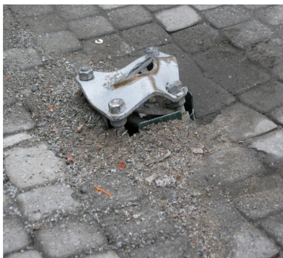
Figur: Manglende sikring/varsling av mastefundament medfører fare for å snuble.
