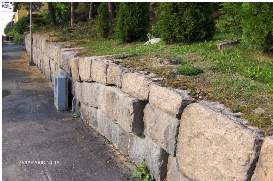
Figur: Muren skal ikke ha skade som reduserer murens funksjon eller stabilitet. Skadene skal heller ikke representere en fare for omgivelsene.
