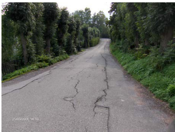
Figur: langsgående sprekker i asfaltdekke
