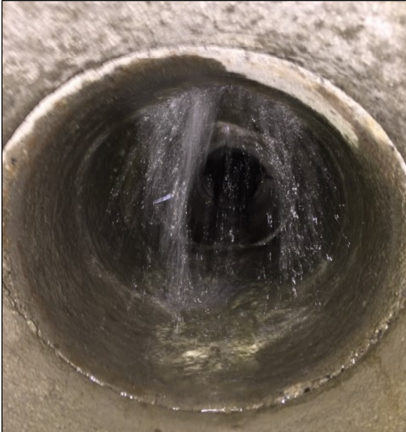
Figur 60: Betongledning med utette skjøter der fremmedvann lekker inn.
