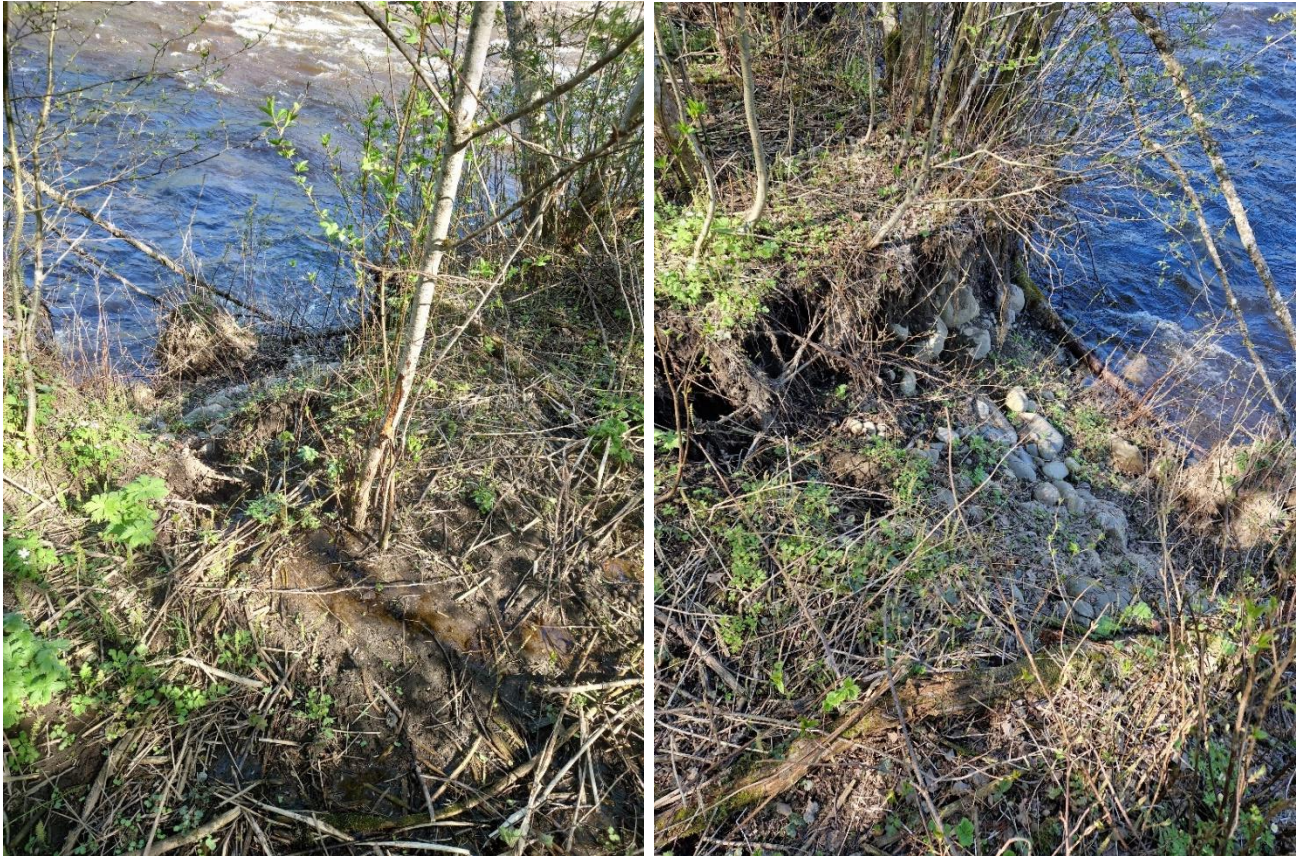
Figur 21: Utløpet i Vismunda for bekken vest i planområdet, sett fra to vinkler. Det er tegn på avsatte finmasser (t.v.) rett før utløpet, samt mye erosjon i selve utløpet (t.h.).
