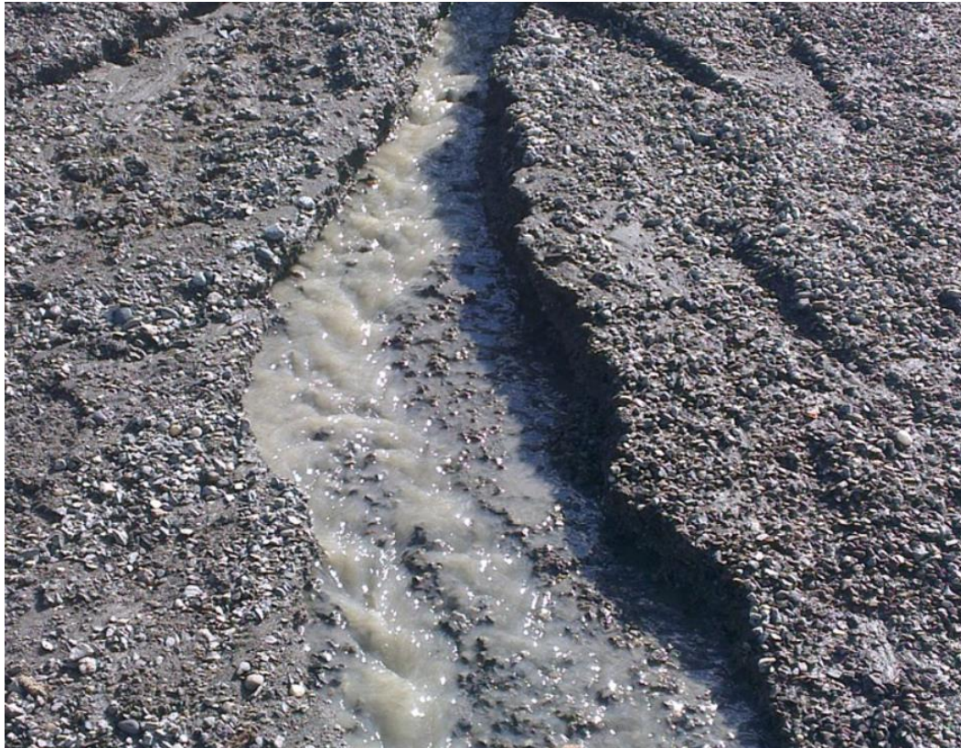
Figur 1. Overvann på avveie – skaper flomskader i veien.
