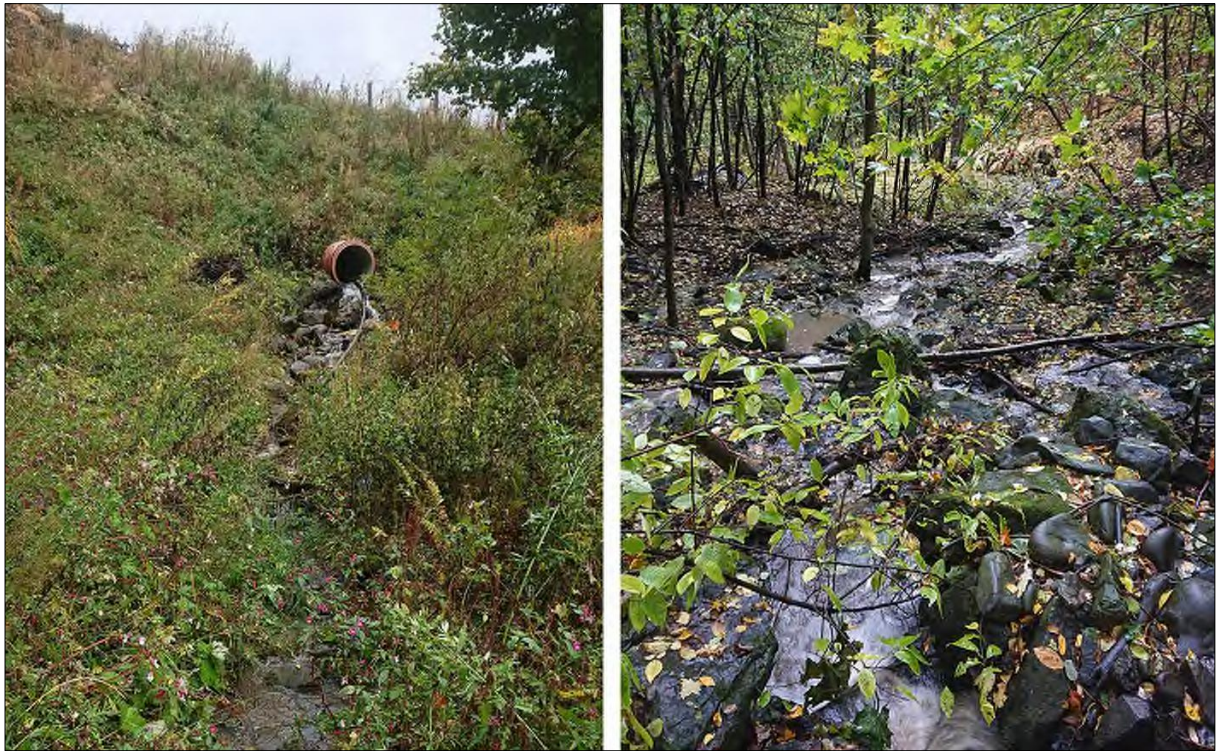
Figur 11. Mælumsbekken går i stikkrenne under dagens E6.
