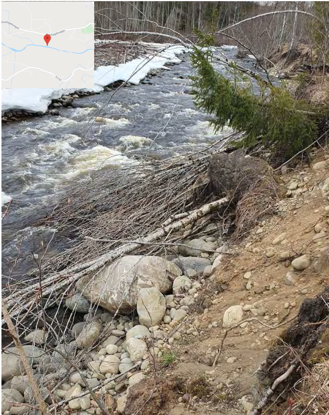
Figur 45 Erosjon på venstre bredd oppstrøms Speiderbakken.
