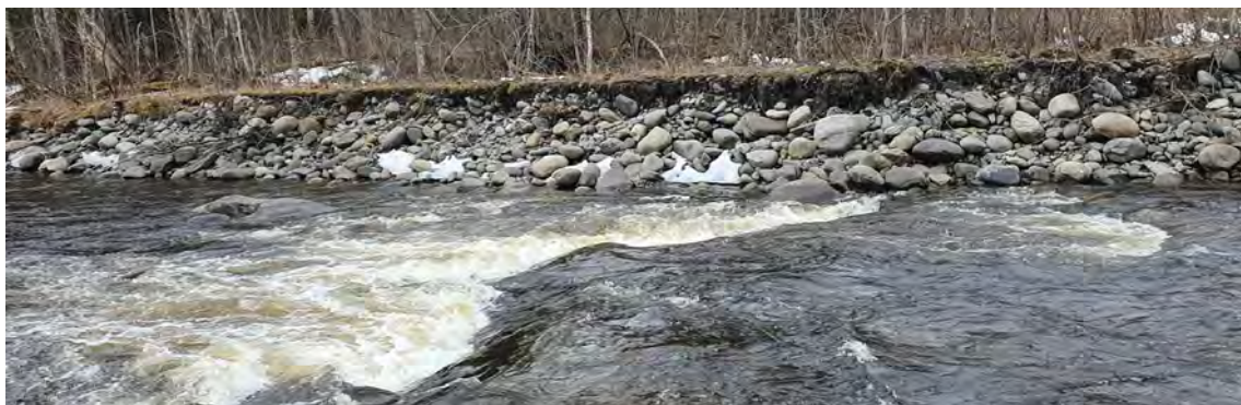
Figur 44 Erosjon i høyre bredd.
