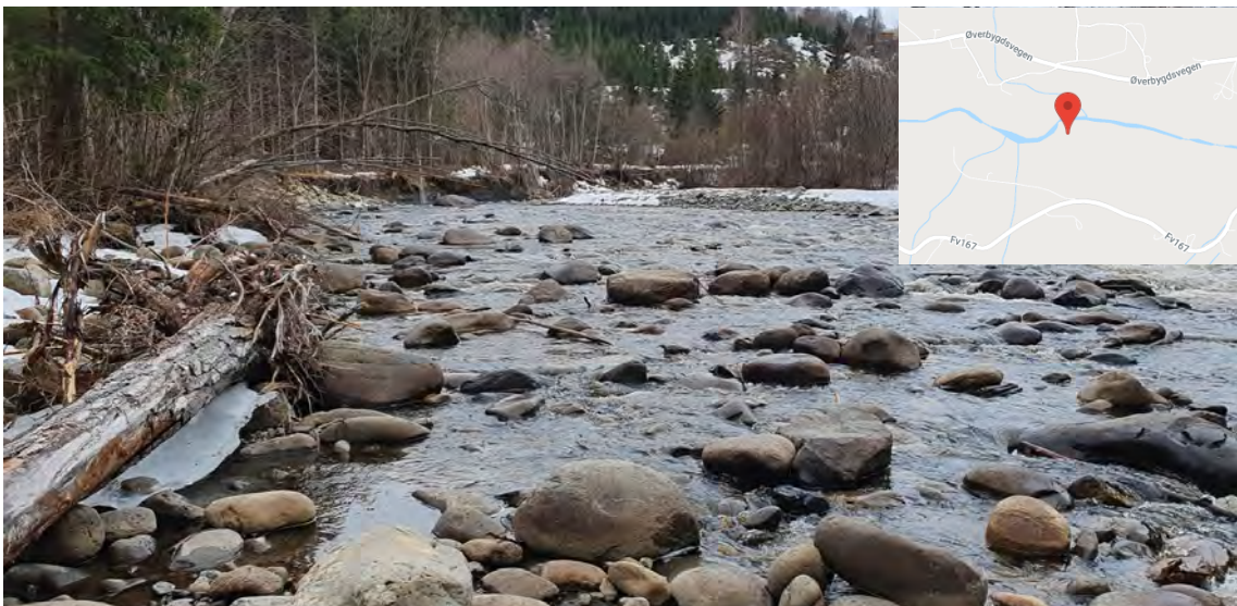
Figur 47 Erosjon i yttersving oppstrøms Lundvollen.
