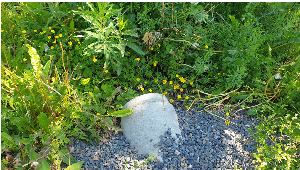
Figur 6 Bakkens utløp er plassert så høyt i veikroppen at vannet samler seg i en dam.
