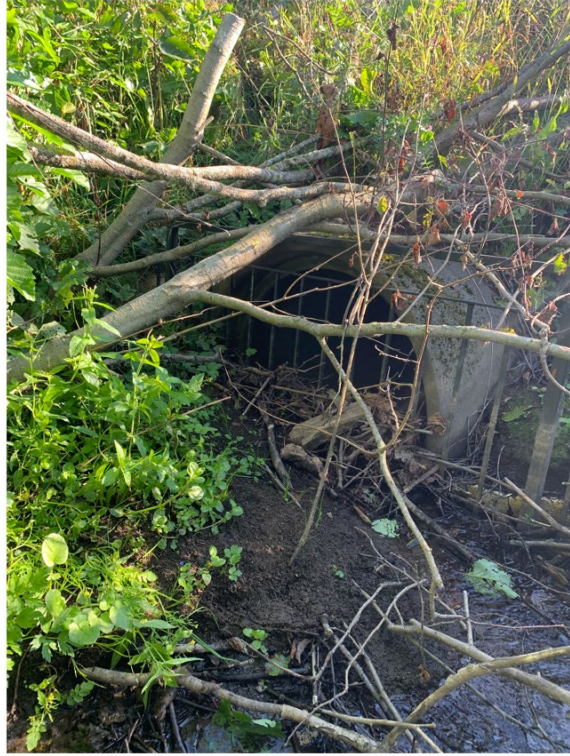
Figur 16. Innløp til stikkrenne under FV 2370. DN 900
