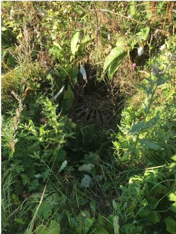
Figur 15. Rist før innløp til stikkrenne under Vestre Totenveg
