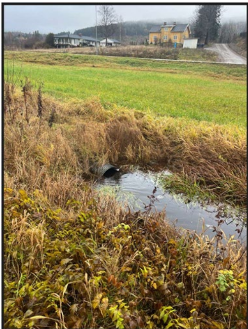
Figur 1 Bilde tatt 25.10.2025 mot Odnervesvegen viser et veldig fullt overvannsrør som ikke tåler å håndtere mye mer vann.
